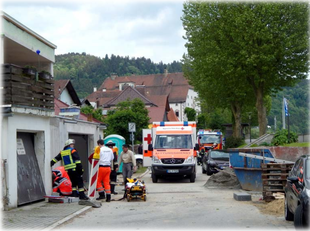
Person Eingeklemmt bei Bauarbeiten in Oberzell
