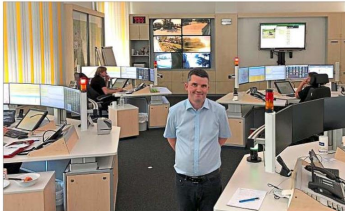
In dieser Kommandozone nehmen Sebastian Fehrenbachs Disponenten Notrufe an und koordinieren Einsätze. Dafür braucht es nicht nur Manpower, sondern auch Material: 71 ISDN-Leitungen und 120 Server stehen bereit.
