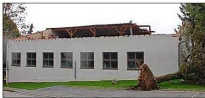
In Sonnen wurde die Turnhalle ein Opfer des Sturms, ...
