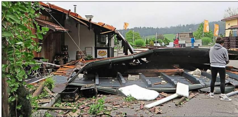
Hunderte Dächer wurden vom Sturm abgedeckt, unter anderem traf es das Lokal „Birreria“ in Hauzenberg.
