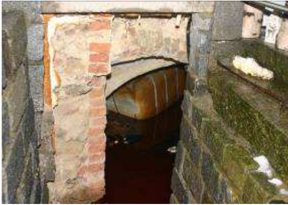
Ölschaden Wiesing, Gde. Aicha v. W..
