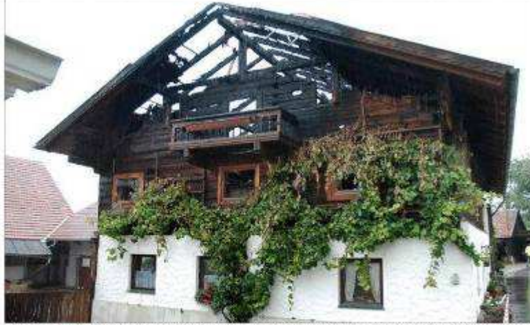
Das stattliche Bauernhaus stammt aus dem 18. Jahrhundert. Bei dem Brand in der Nacht zum Montag wurde es fast völlig zerstört – vom Feuer vom Pflanz und vom Viehstall.
