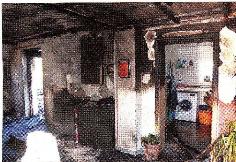
Völlig zerstört sind die Wohnräume im Obergeschoss. Die Wände sind verrußt, am Boden liegen verkohlte Haufen und von der Decke tropft das Löschwasser. – Fotos: Baumgartl
