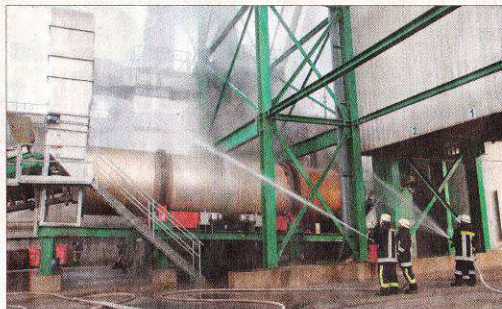
Von unten wurde ebenfalls Kühlwasser auf die Behälter der Filteranlage gespritzt.
