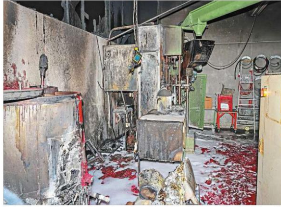
Ein technischer Defekt an der Stumpenkerzen-Pressanlage hat den Brand in der Kerzenfabrik Kopschitz ausgelöst. Deren Wert liegt bei rund 250 000 Euro. Weit größerer Schaden ist durch die Zerstörung der Infrastruktur entstanden. – Fotos: Danny Jodts/ zema-medien.de (2)
