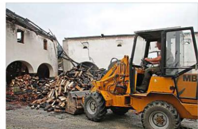
Am Donnerstag begann das große Aufräumen. Mit einem Lader wurde das Holz beseitigt.
