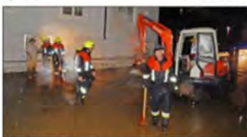
Sobald das Wasser zurückging, begannen Feuerwehren und viele weitere Helfer mit den Aufräumarbeiten. Hier räumt man mit Hilfe des Baggers den Schlamm von der Bundesstraße 388.
