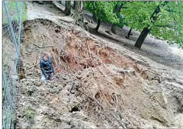
Im Wildpark beim Schloss spülte es einen ganzen Hang weg. Der Schaden hier ist enorm, da umgestürzte Bäume Zäune zerstörten. Der Förderverein Bereich Schloss Ortenburg hat zu Spenden aufgerufen. – F.: Niederhofer
