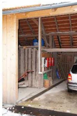
Zugang zu den Wechselrichtern / Sicherungskasten
