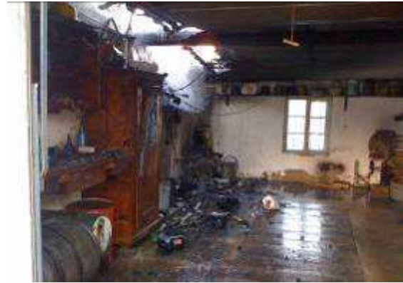
Garagenbrand Lindach - Gde. Tiefenbach
